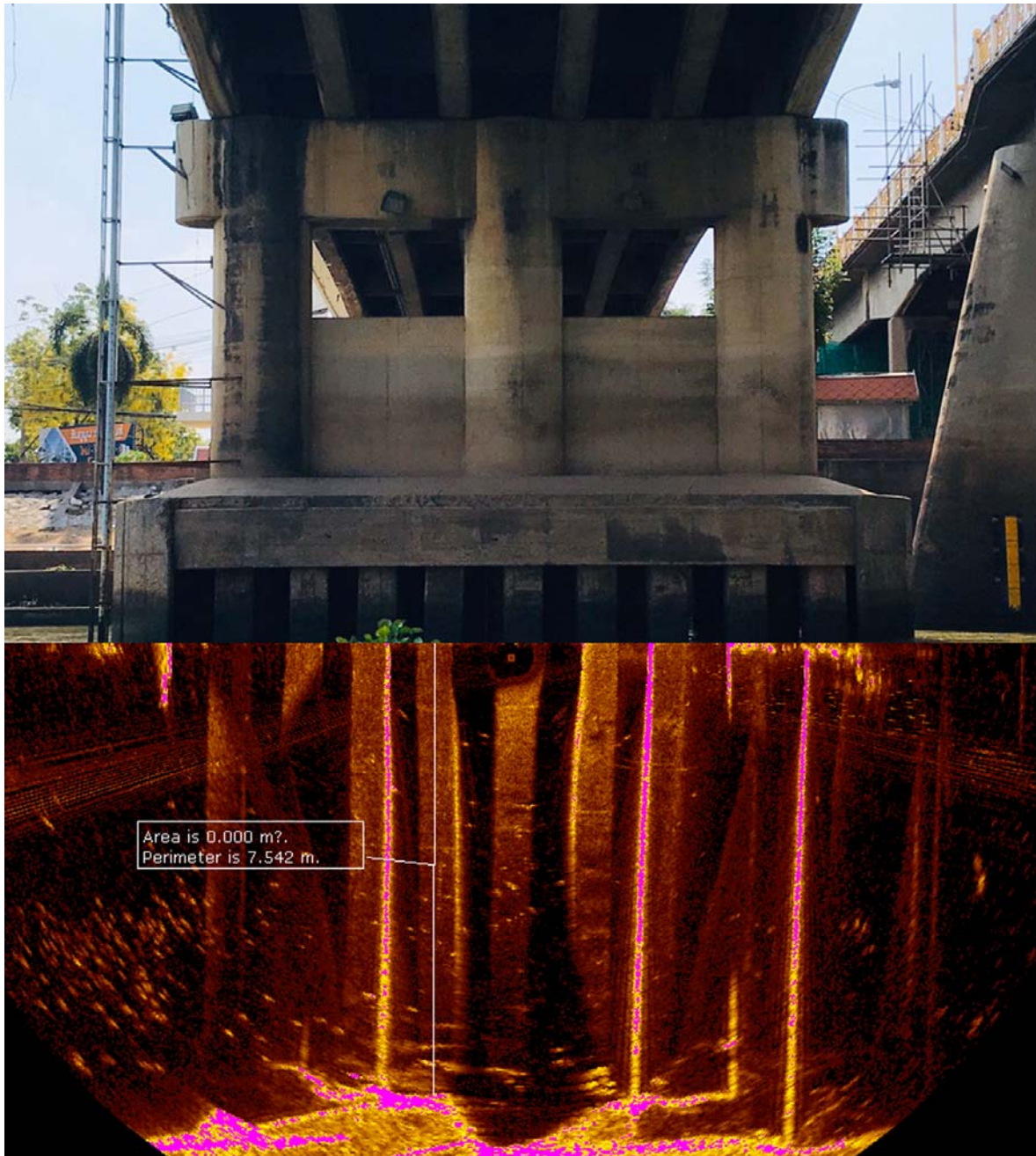
รูปที่ 4-13 ผลการสำรวจสภาพโครงสร้างใต้น้ำตอม่อ P4 สะพานสมเด็จพระนเรศวร ด้าน วังน้อย
