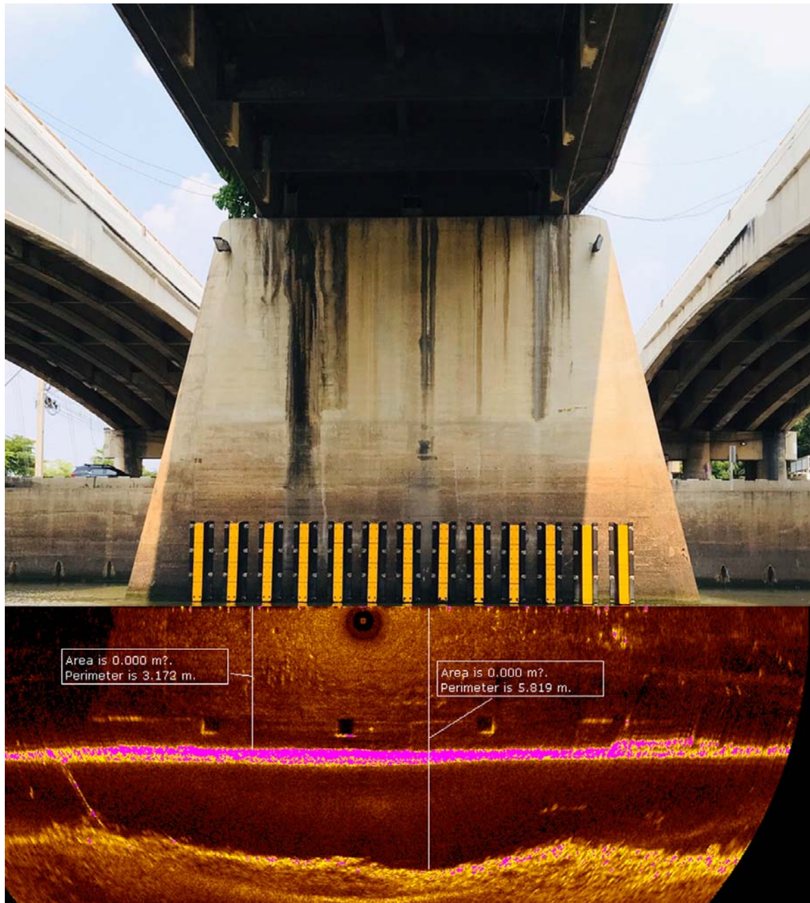
รูปที่ 4-8 ผลการสำรวจสภาพโครงสร้างใต้น้ำตอม่อ P3 สะพานปรีดี-ช้าง ด้าน อยุรยา
