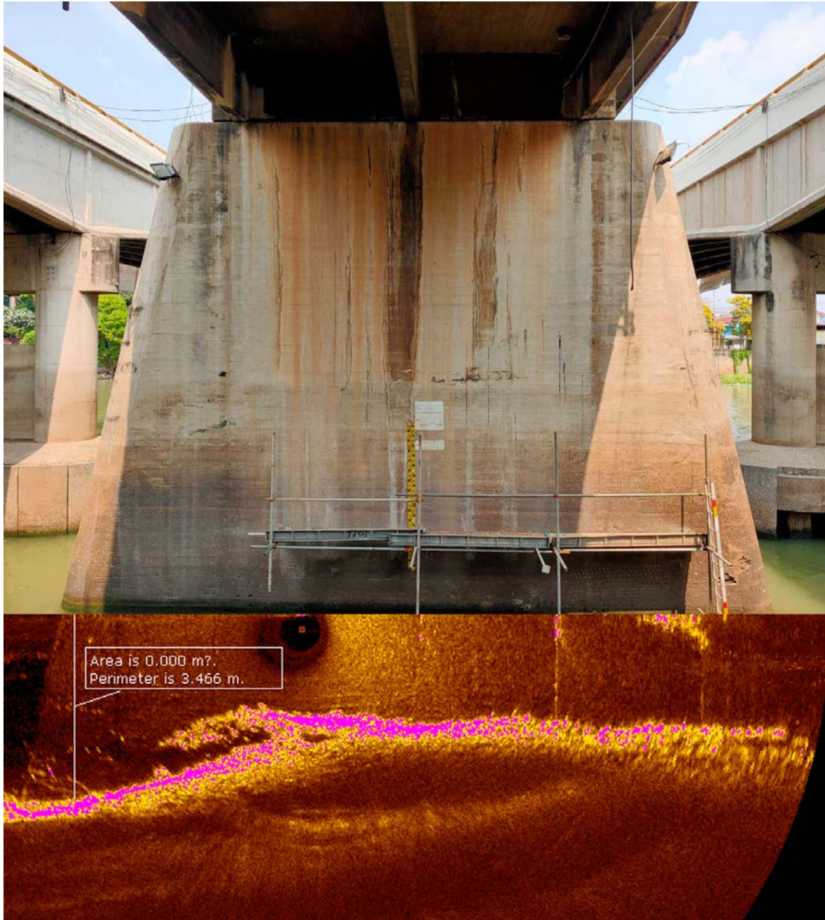
รูปที่ 4-10 ผลการสำรวจสภาพโครงสร้างใต้น้ำต่อม่อ P4 สะพานปรีดี-ช้างรง ด้าน อยุธยา
