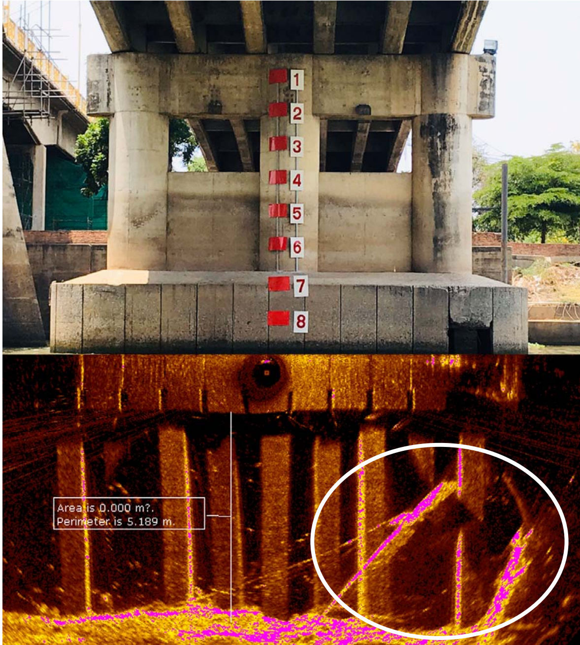
รูปที่ 4-17 ผลการสำรวจสภาพโครงสร้างใต้น้ำตอม่อ P4 สะพานสมเด็จพระเอกาทศรถ ด้าน วังน้อย
